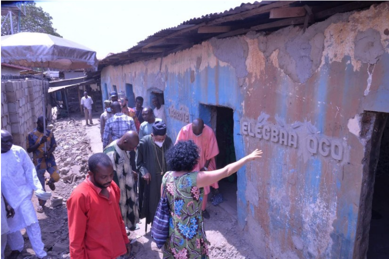
Restauração do santuário de Èṣù Akesan (Elegbaa) , em Òyó Aláàfin . Imagem cedida pela Dra. Paula Gomes
